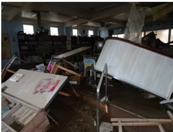
令和2年7月豪雨で生じた図書室への浸水
