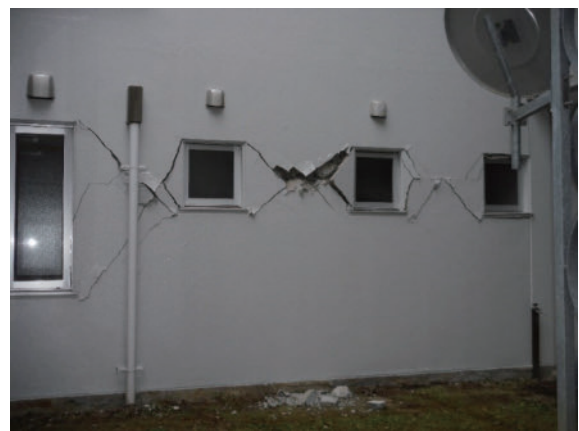
福島県沖を震源とする地震で生じた外壁の亀裂
