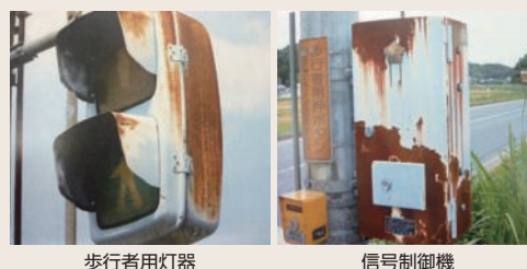
図表5-45 老朽化した交通安全施設
